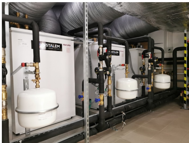
Obr. Zrealizovaná inštalácia tepelných čerpadiel
